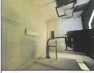
Interior Sala Generador 110 KVA
