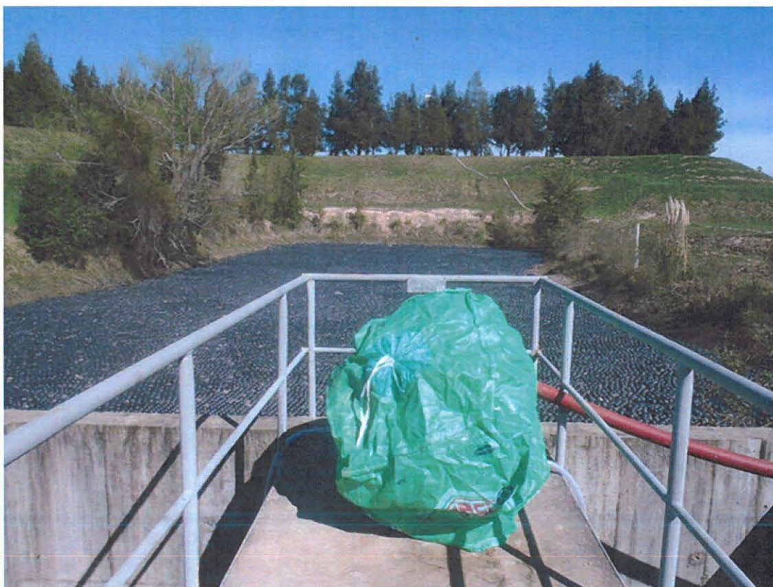
Figura 102: Bomba de extracción instalada en la pileta de pluviales N°1 observada durante el ingreso de agosto de 2022.
